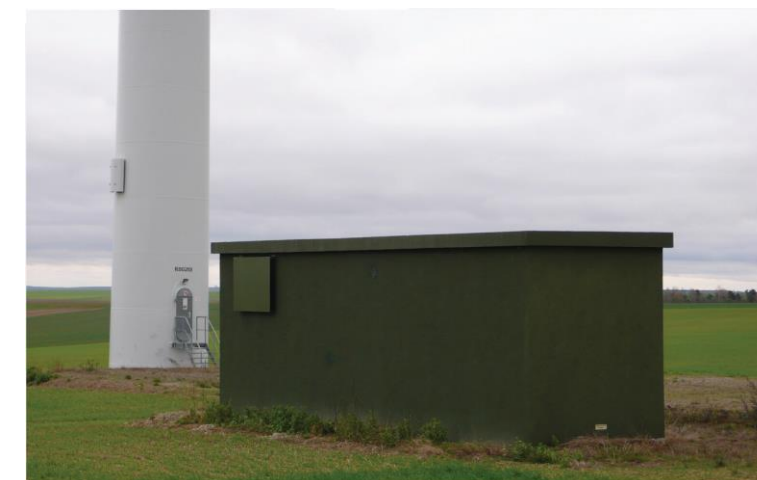
Figure 78 : Exemple de poste de livraison
