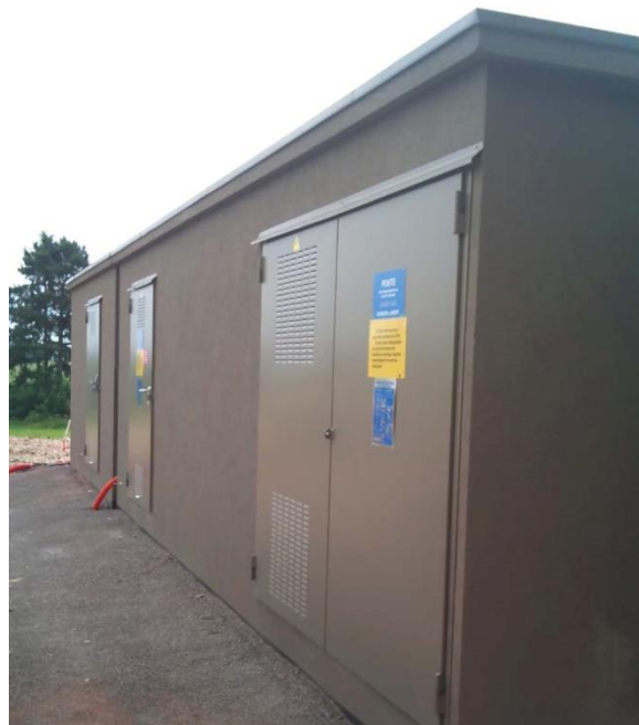
Figure 48 : Exemple de poste de livraison
